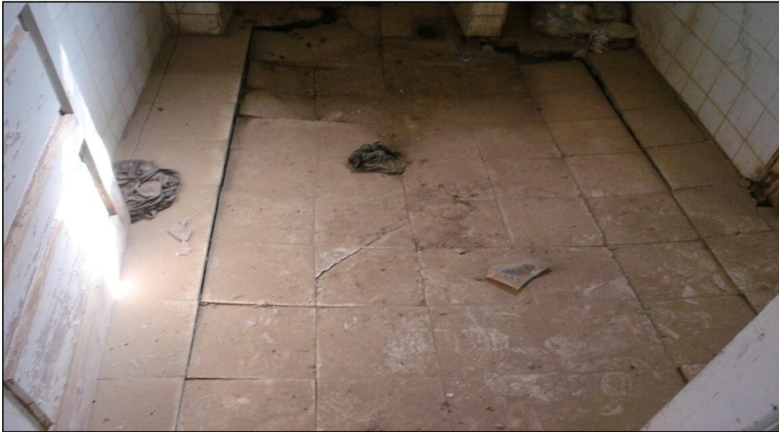
شكل رقم (2) تكسر بلاط الأرضيات في المباني في موقع البحث بسبب التربة الغضارية الانتفاخية
